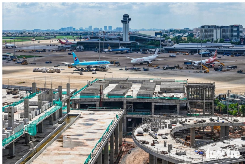
Nhà ga T3 sân bay Tân Sơn Nhất (Dự kiến hoàn thành Q2/2025)
